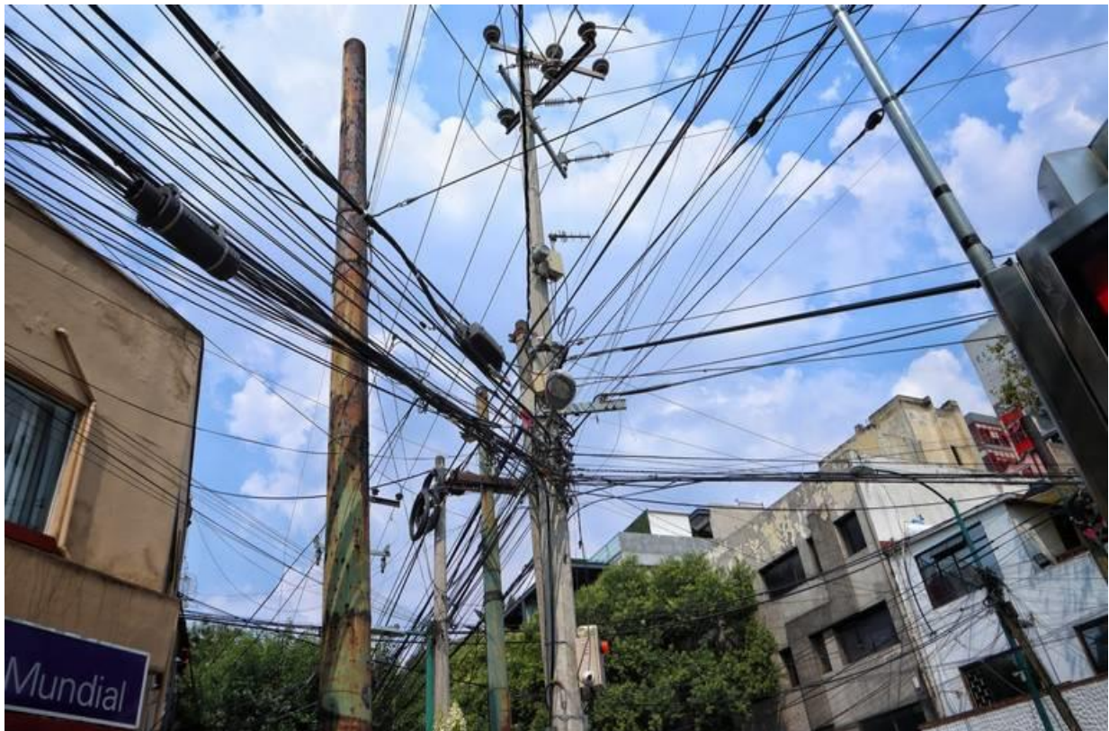
Fuente: La Prensa. Empresas han retirado cableado en desuso que contaminan espacio aéreo en la Cuauhtémoc.
