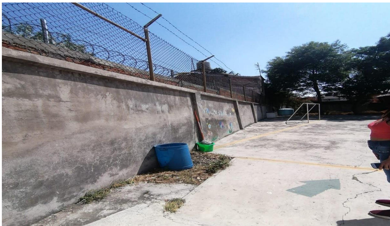
Barda de la escuela primaria Fray Antonio Margil de Jesús, ubicada en la colonia San Francisco de la alcaldía Coyoacán. Se percibe inclinada hacia la calle, representando un riesgo para estudiantes, maestros, padres de familia y peatones de la zona. (2022).
