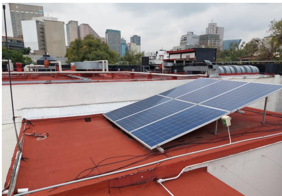
Figura 16. Paneles solares instalados en azotea del inmueble en estudio. Elaboración propia.
